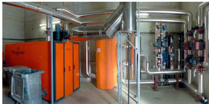
La chaufferie située à l'étage du nouveau bâtiment reçoit deux chaudières biomasses polycombustibles, de 200 kW chacune.
